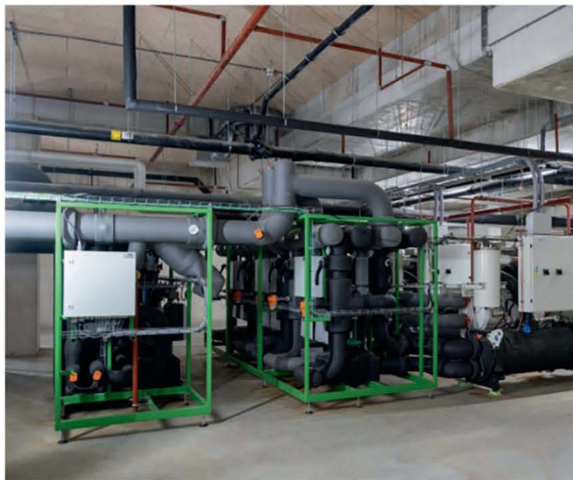
Hanab Installation Technology was verantwoordelijk voor het ontwerp en de realisatie van alle gebouwgebonden installatietechniek.
